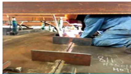
2018年广西防城港核电站安全壳 钢衬里无损检测造假
