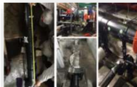
大亚湾CFI改造项目 (HDPE应用)
