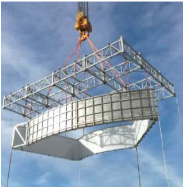
内置换料水池模块
