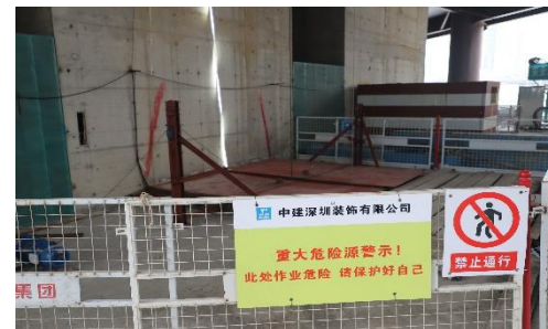
重大危险源警示
