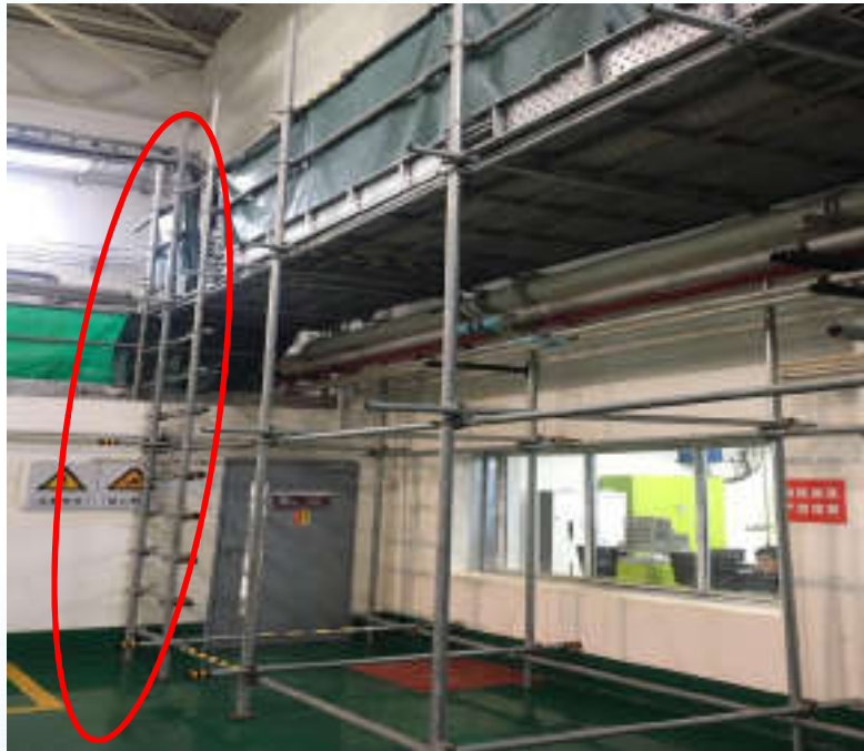
超出5m的直爬梯未使用防坠器等安全辅助设施
