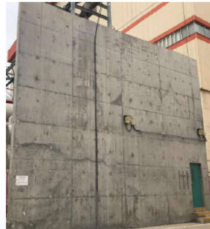
防火墙清水混凝土色差较大
