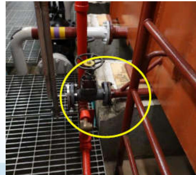
阀门位置布置不合理 (为保障阀门按照破坏设备基础)
