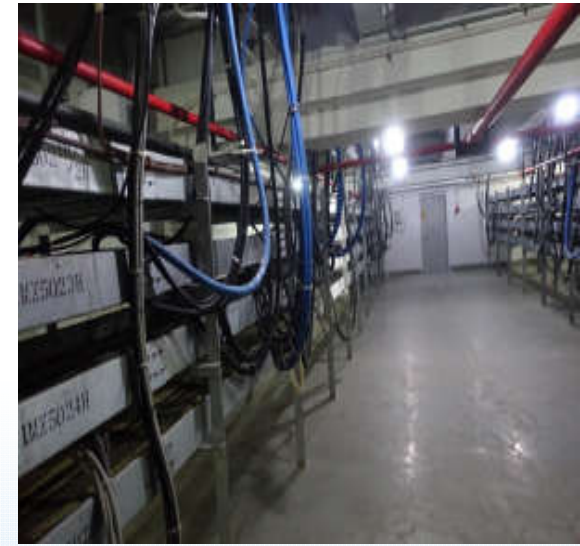
电缆敷设路径不合理，桥架电缆溢出严重
