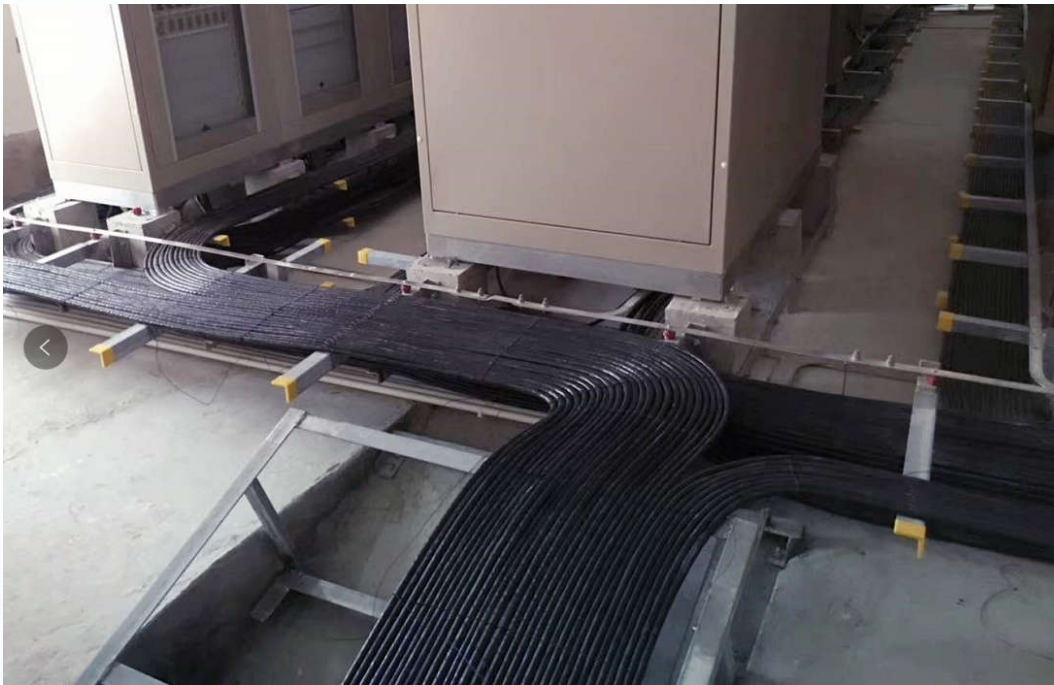
某国优工程电厂电缆敷设效果
