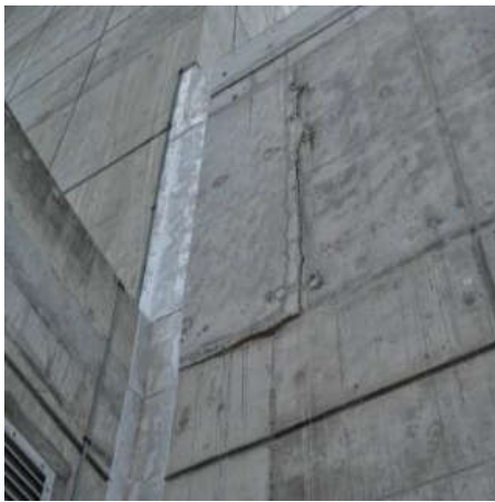
混凝土立面错台明显
