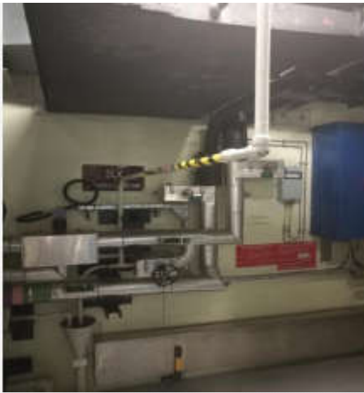
管道布置在人行通道上方且高度不够
