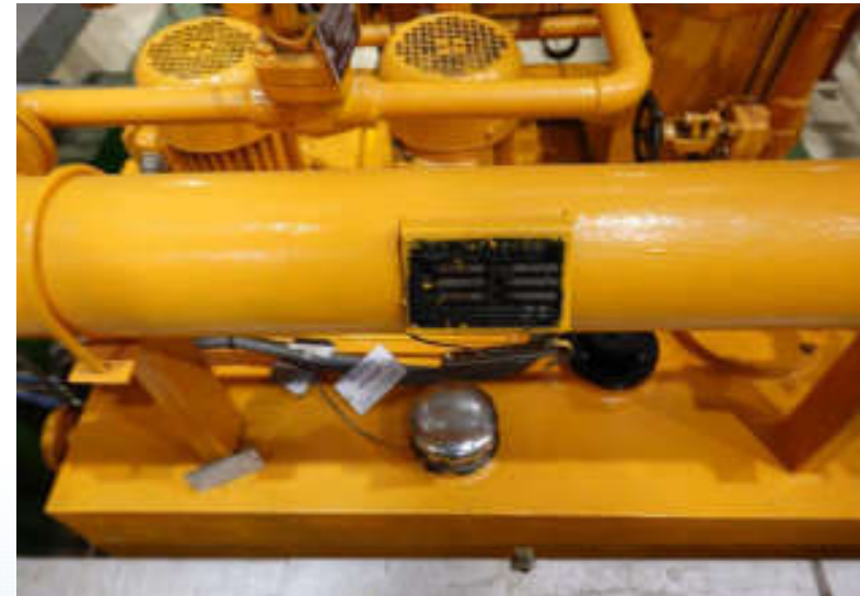
列管式油冷却器下方漏油
