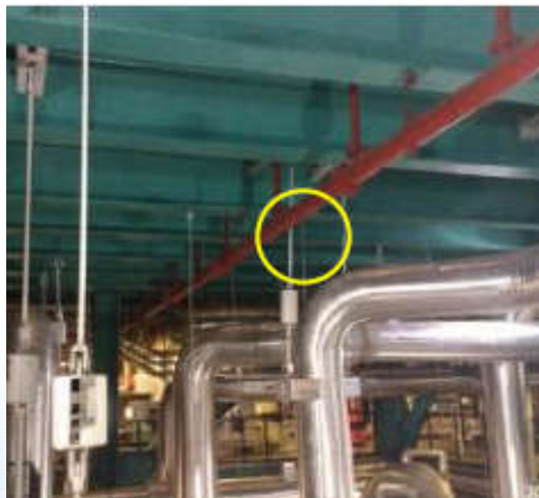
管道支吊架与消防管道干涉
