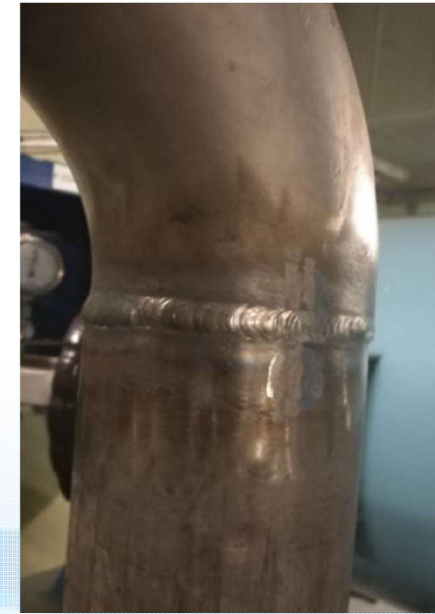
直管段与弯管段接口错变量超标
