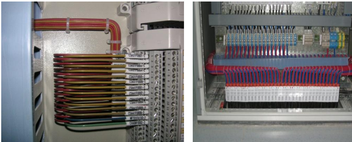
12.3 二次线电缆端接效果照片
