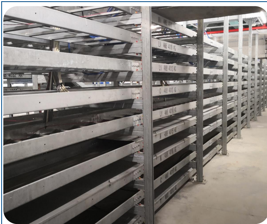
电缆桥架安装规范，工艺美观
