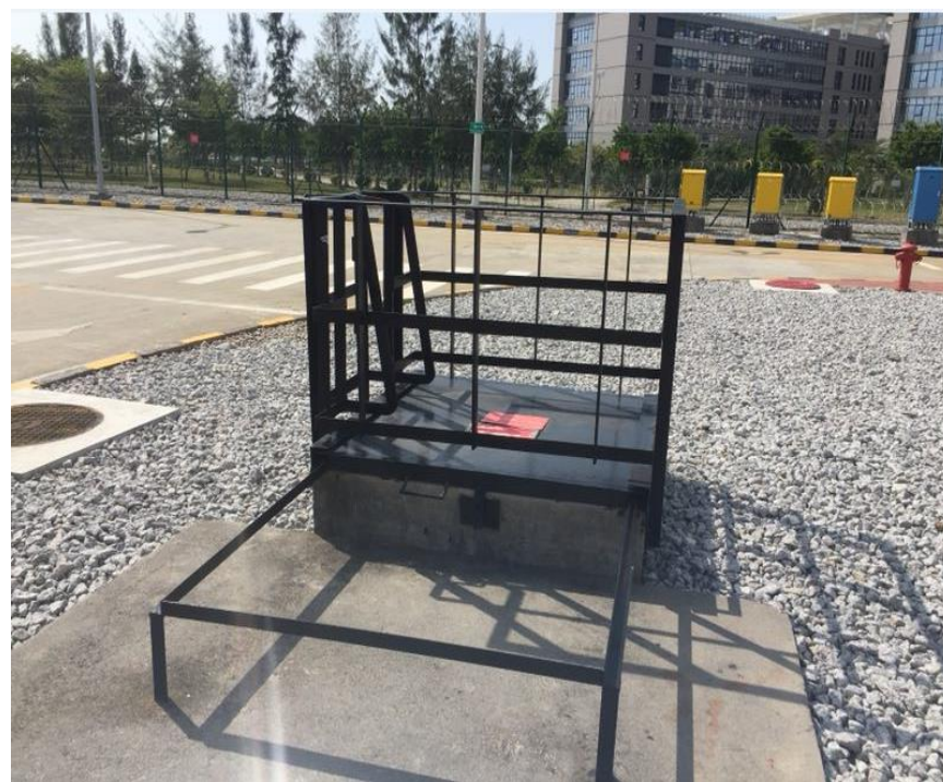
廊道人孔入口设有实体围栏、自闭门和扶手，提升安全水平
