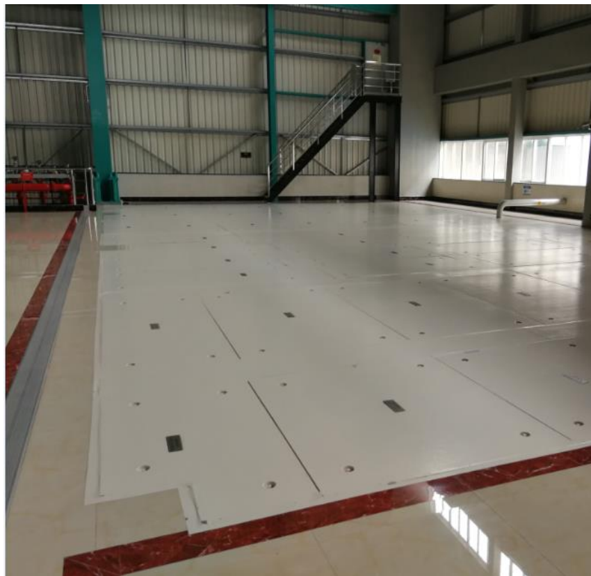
4MX润滑油室盖板缝隙规整、油漆亮堂
