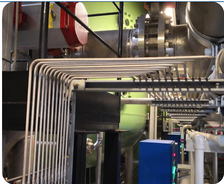
取样管安装工艺美观 (2)
