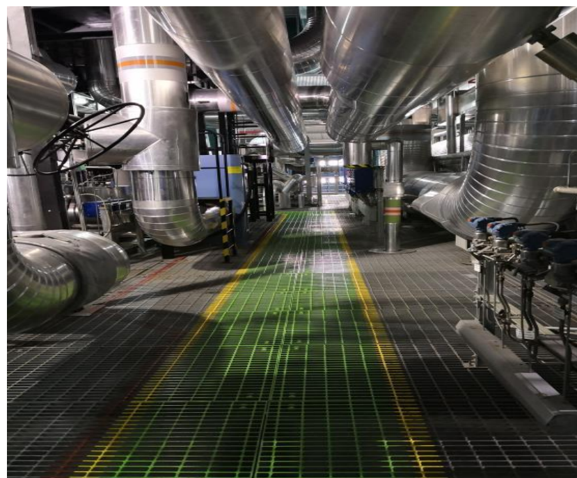
钢格栅盖板人员通道清晰，整齐美观
