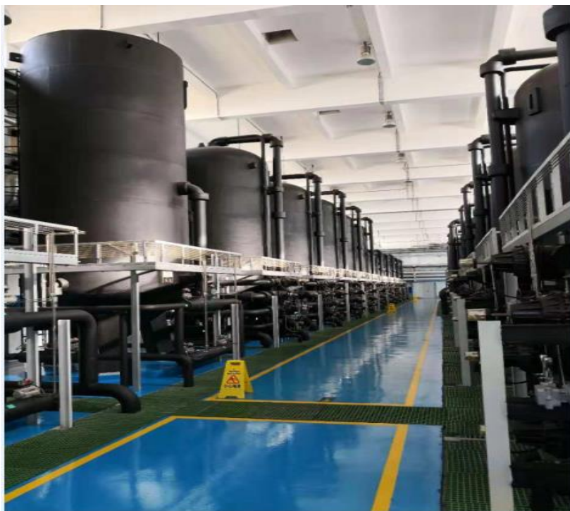
采用冷保温装置，解决冷凝水造成地面湿滑问题
