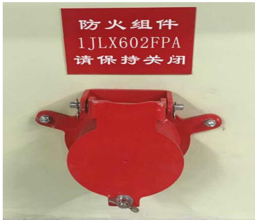
防火组件、减少防火门不必要开启时间
